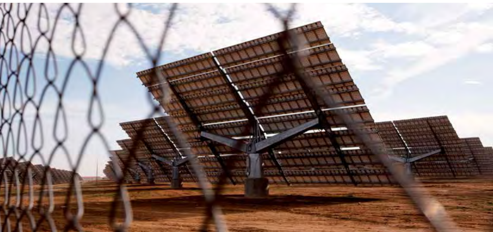
Paneles solares en el desierto de los Monegros, Aragón.
