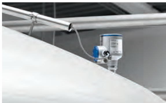
Medida de nivel en un tanque de leche
