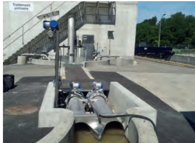
Medida de caudal de aguas residuales en tubos parcialmente llenos
