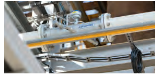
Medida de gas en una planta de fabricación de plástico
