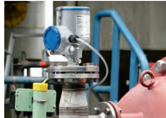
Medida del nivel de butanol en una cámara de bypass
