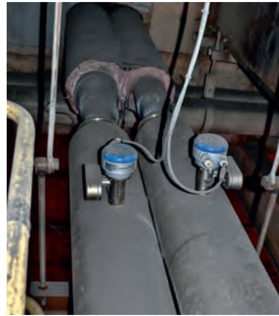
Medida de caudal másico de combustible pesado
