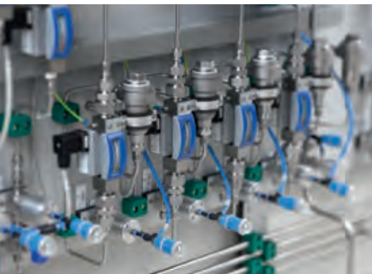
Inertización con rotámetros de purga
